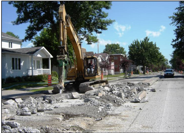
Les travaux d'infrastructures sur le boulevard Manseau ont débuté le 3 juillet par la démolition de la partie centrale en béton.
